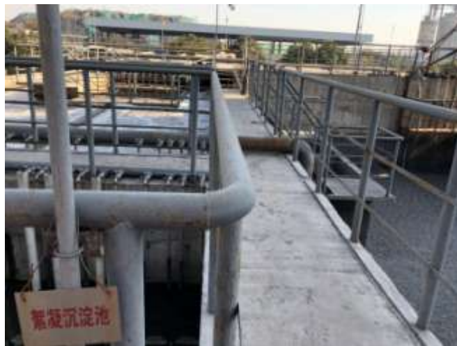
北厂区依托的污水处理站
