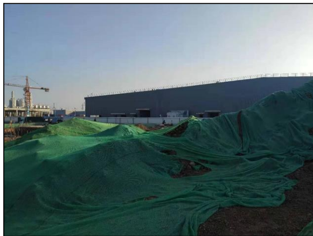
二期污水处理站占地
