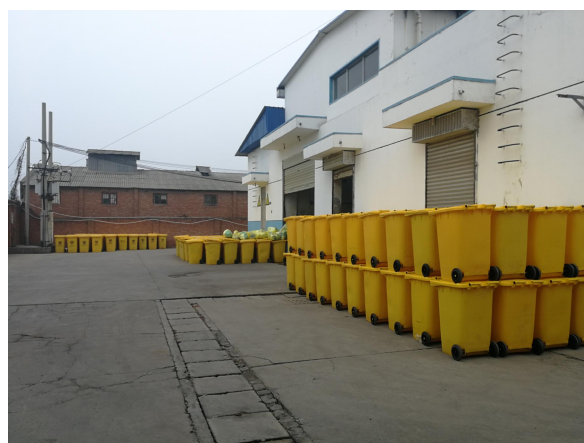
卸车区水泥地面开裂
