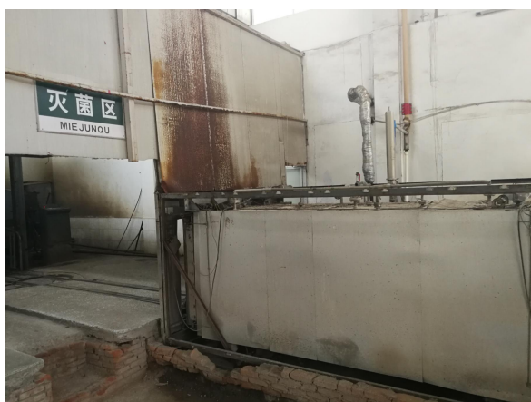
车间地面水磨石板破损或缺失
