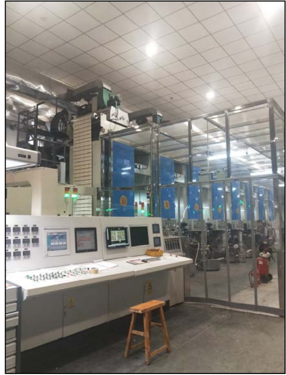
凹印机废气收集装置
