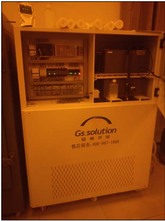
冲版水回收利用装置
