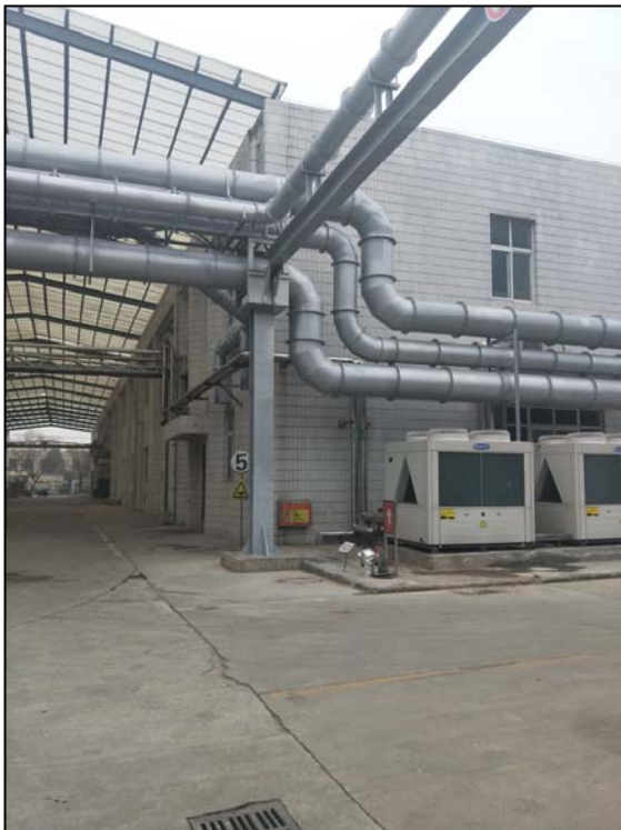
wfh 废气收集管道
