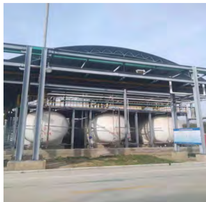
现有的氯甲烷储罐区
