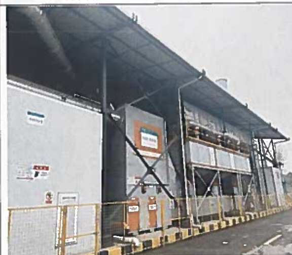
现有有机废气处理装置（活性炭、催化燃烧）
