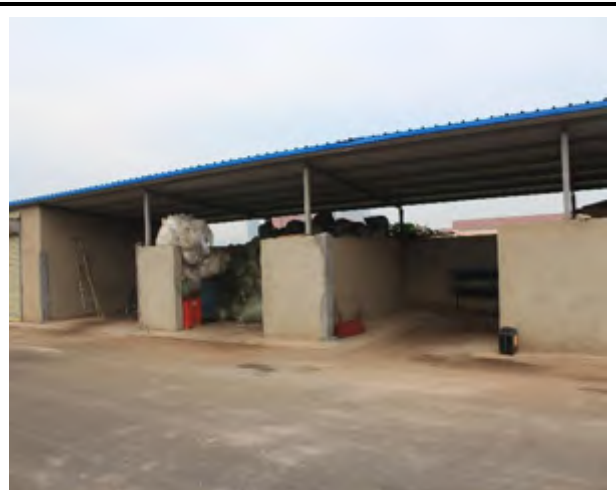
现有一般固废暂存间
