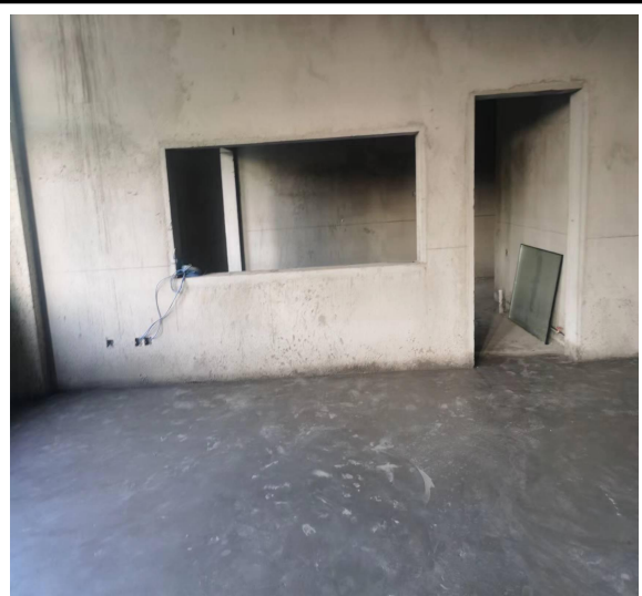
急救中心综合楼3楼复合手术室--DSA 机房
