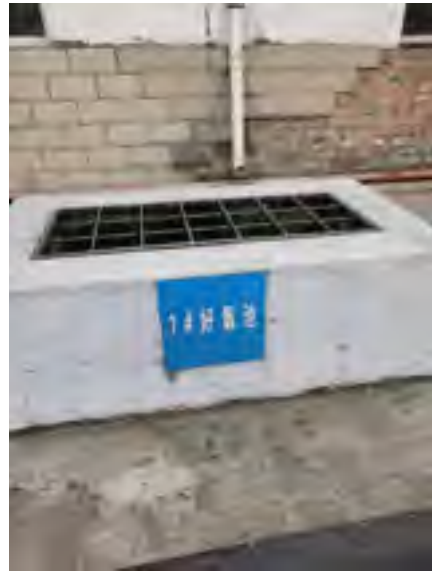
生活污水处理系统
