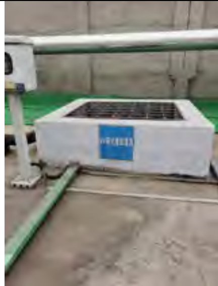
生活污水处理系统
