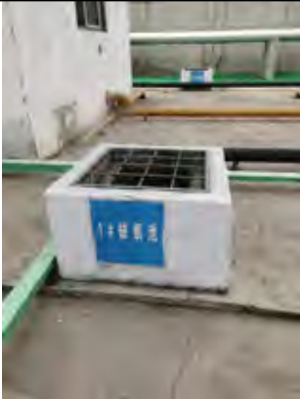
生活污水处理系统
