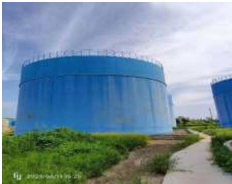
现有草甘膦母液储罐
