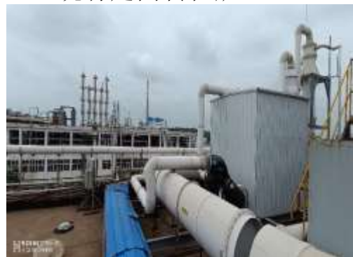
现有污水处理站尾气处理装置
