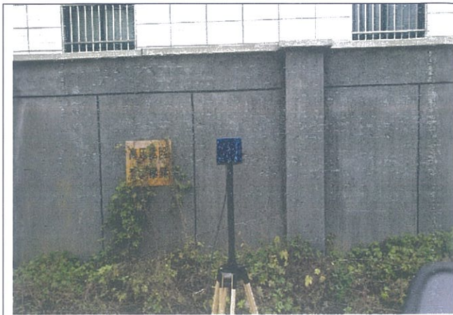
Pic1 柏梁 110kV 变电站
