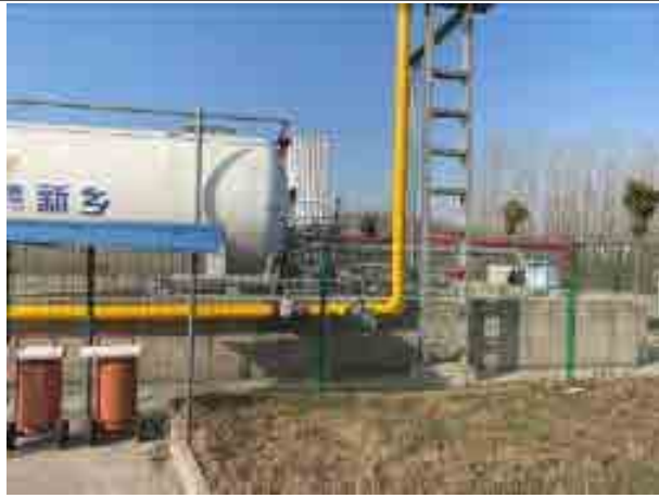
现有工程 LNG 供气站
