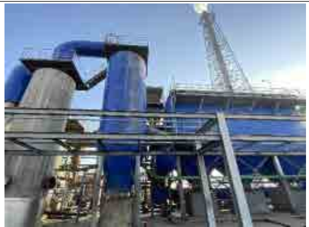
现有工程定向转化尾气治理设施及排气筒
