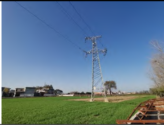
跨越 110kV 襄汝线
