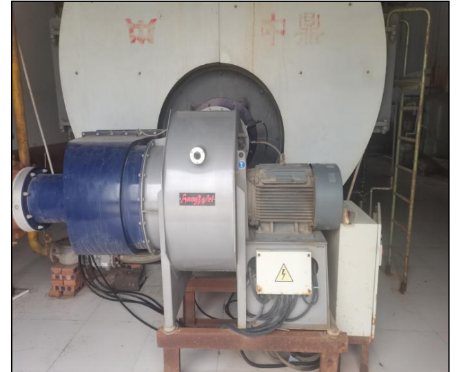
待拆除天然气锅炉
