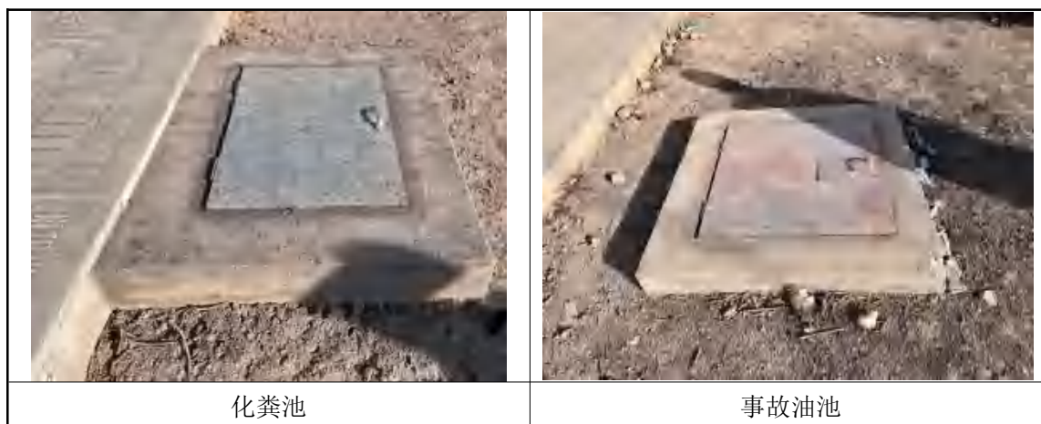
图2-4 110kV 朝阳变电站内环保设施
