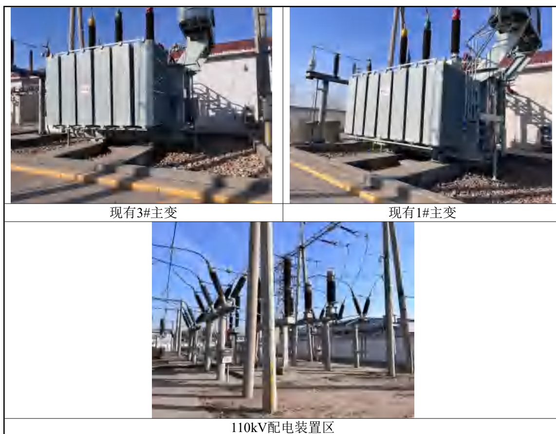
图2-3 110kV 朝阳变电站内相关设施
