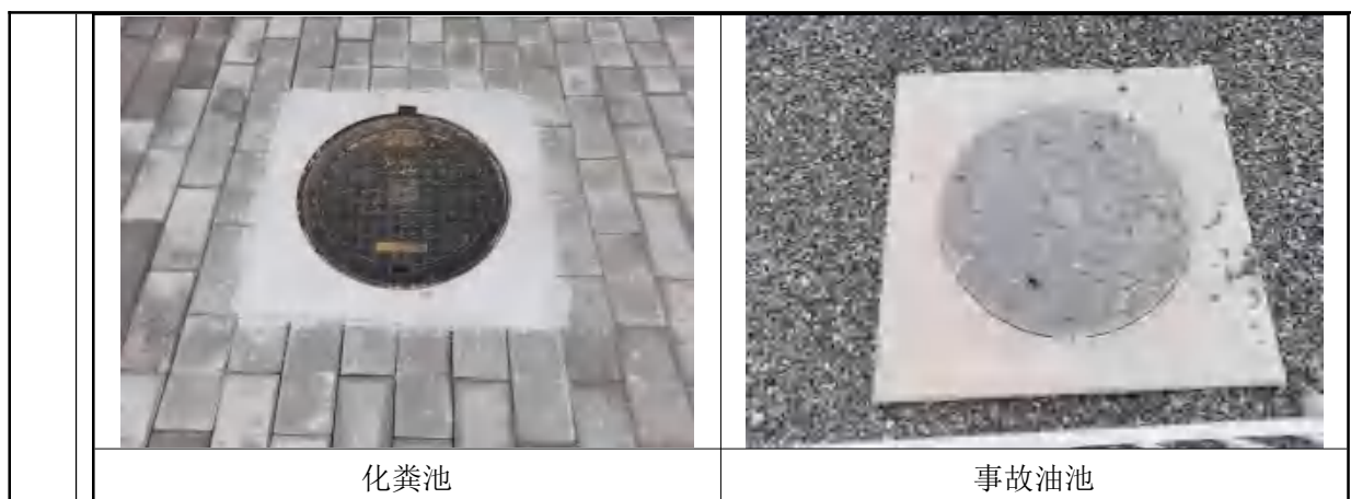
图2-2 220kV 灌台变电站内环保设施
