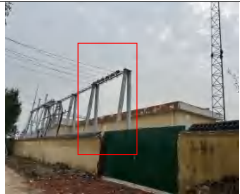
110kV 桂村变出线间隔（拟改建）
