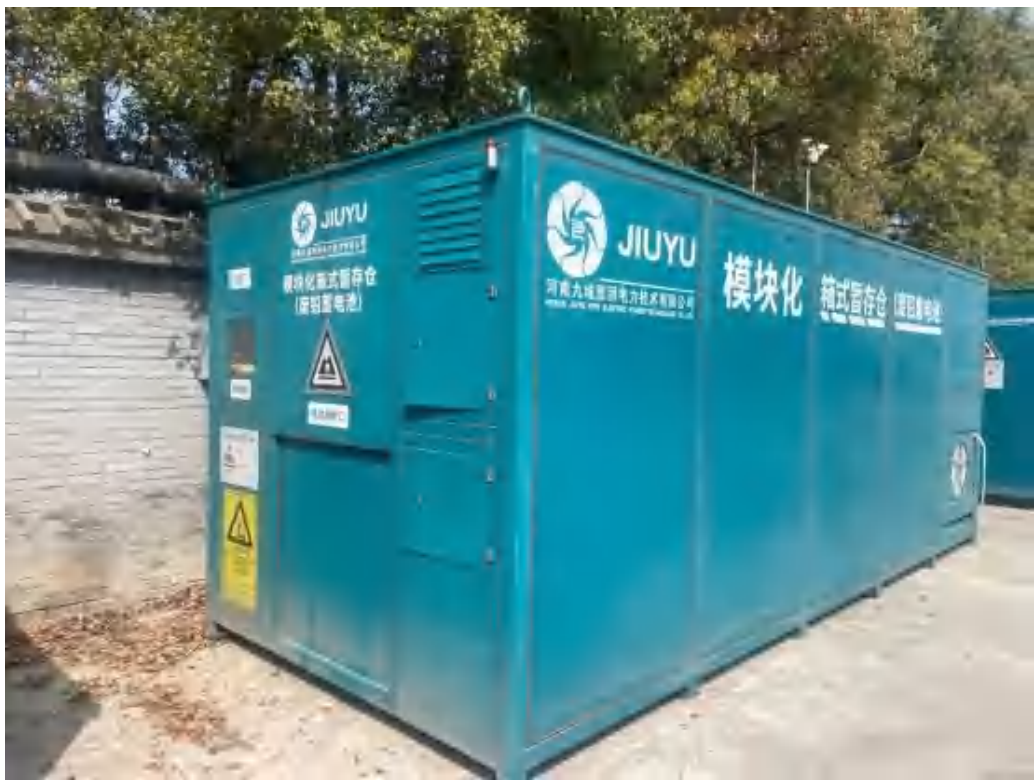
图 4-6 国网许昌市供电公司废铅蓄电池暂存仓照片
