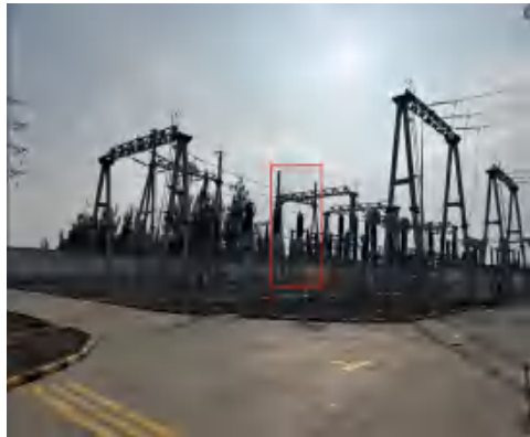
110kV 泉店变入线间隔
