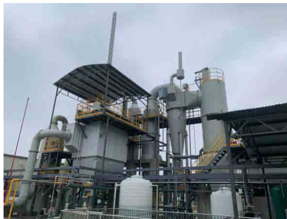
改建后危废焚烧炉
