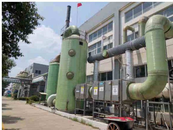
11 车间 UV 光氧+活性炭设备拆除前现状
