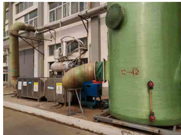
12 车间 UV 光氧+活性炭设备拆除前现状
