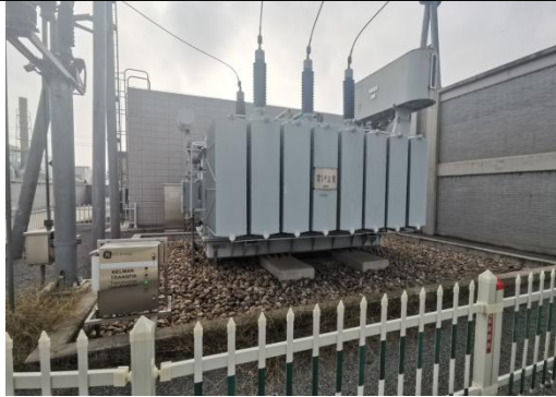
已建 1#主变压器
