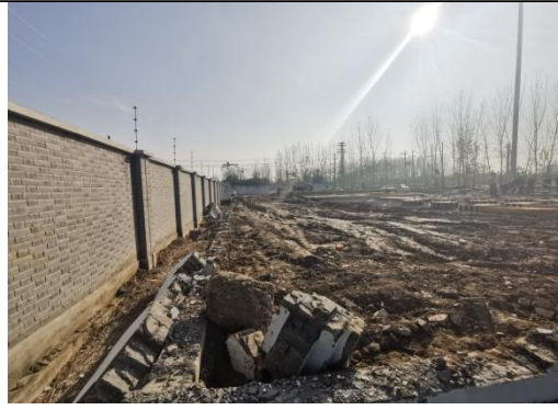
建安 110kV 变电站站外西侧
