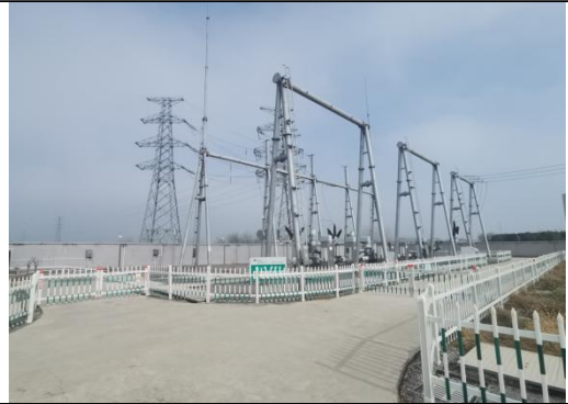
110kV 配电装置区
