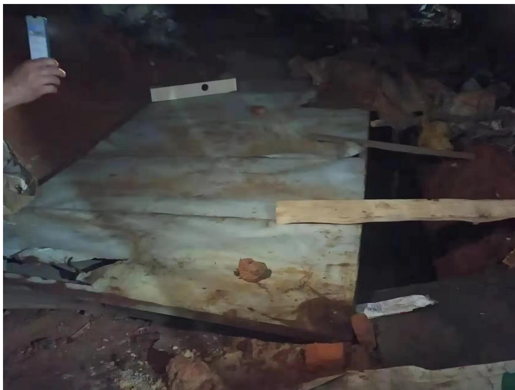
王某镀锌加工厂渗坑照片
